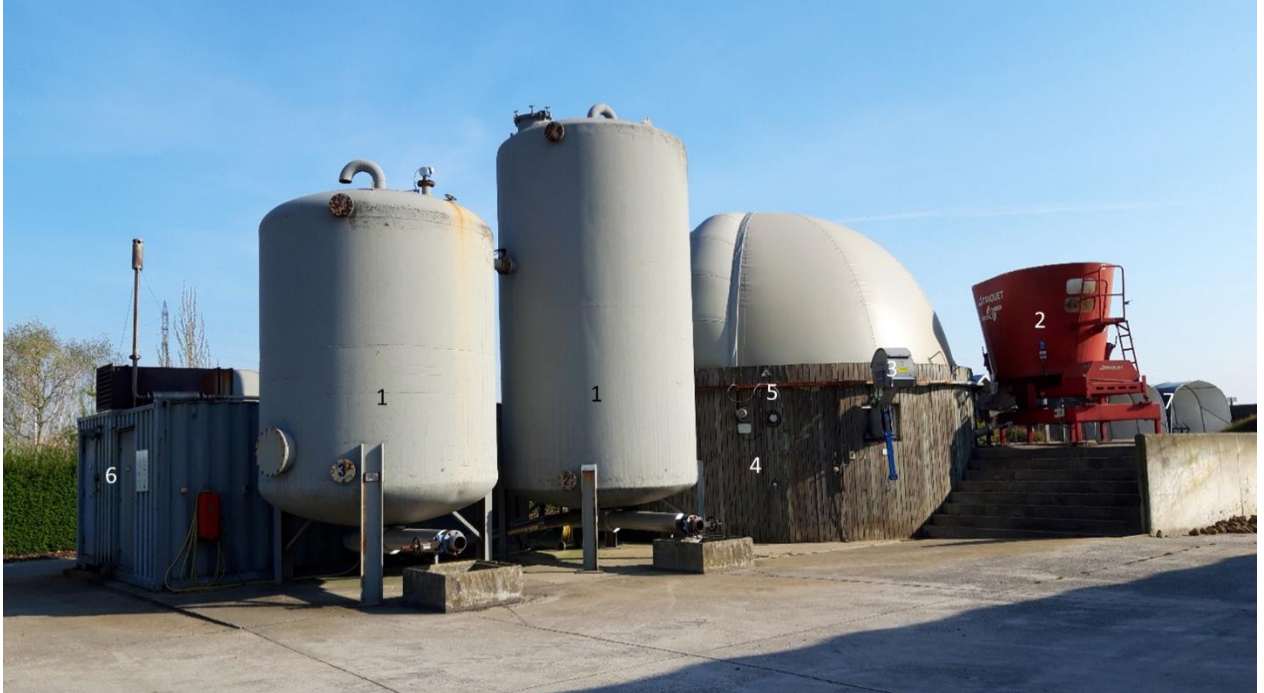
Figuur 2: Overzicht van de pilotinstallatie op Inagro: (1) Opslagtanks voor de vloeibare varkensdrijfmest; (2) Trioliet schroefpers om de VeDoWS-varkensmest te voeden; (3) Mixer; (4) Reactor; (5) Luchtinjectie voor biologische ontzwoeling; (6) WKK; (7) Gedeeltelijk overdekte sleufsilo's voor de opslag van VeDoWS-varkensmest
